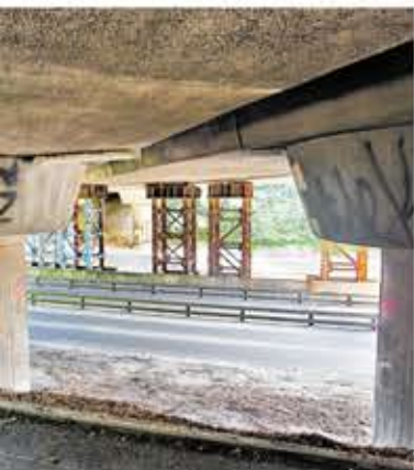
Die Brücke ist bereits provisorisch verstärkt worden. FOTO: DIETMAR WÄSCHE
